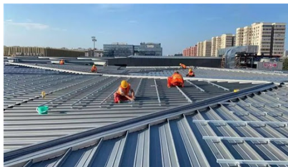
2022年北京冬季オリンピックの競技場 屋上に設置された分散型発電設備
